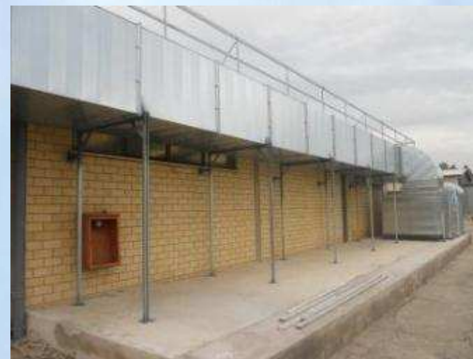
Centrale Produzione Aria Climatizzata
