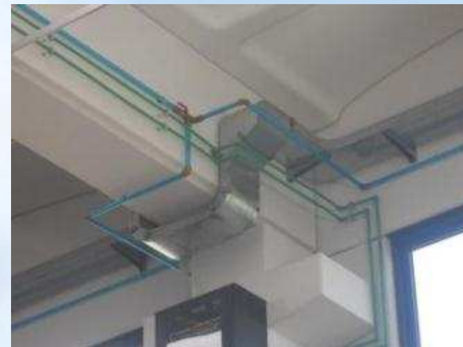
Particolare di Impianto distribuzione Aria realizzato con tubi in alluminio anodizzati
