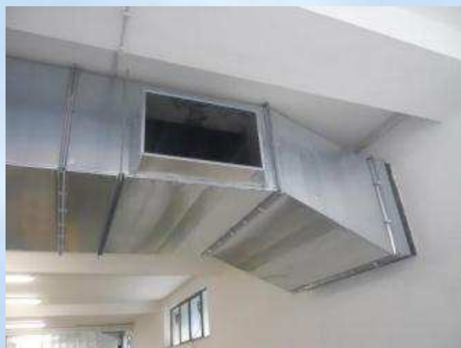
Particolare condotta emissione, estrazione Aria
